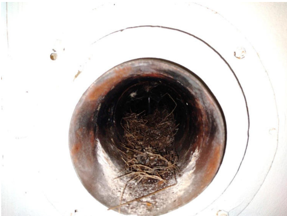
Abb. 8: verlassenes Nest in einem Rohr in einer Kleingartenhütte
